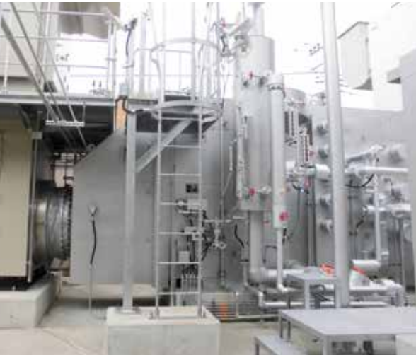
神奈川県 某化学会社 ●ガスタービン 1.7MW ●蒸発量 4.8t/h ●貫流ボイラ
