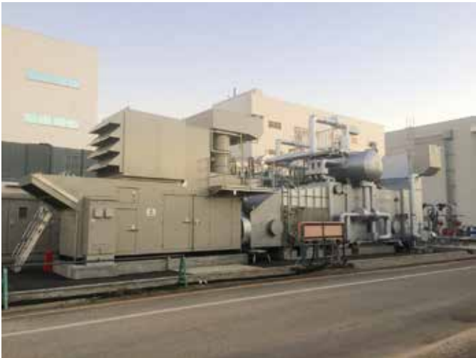
茨城県 某製薬会社 ●ガスタービン 1.7MW ●蒸発量 10.9t/h
