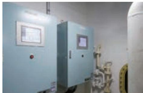
機関室側コントロールパネル
