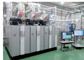
ボイラ実証ルーム
